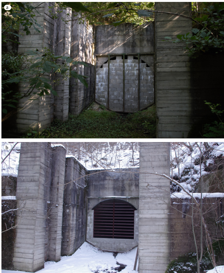
Ryc. 28. Ścianka z bloczków w wejściu do zimowiska powoduje zmniejszenie przepływu powietrza i podniesienie temperatury w podziemiu (a). Krata z poziomymi elementami (b) nie blokuje ciągu powietrza i umożliwia nietoperzom swobodny wlot do schronienia (fot. Iwona i Tomasz Gottfried)
